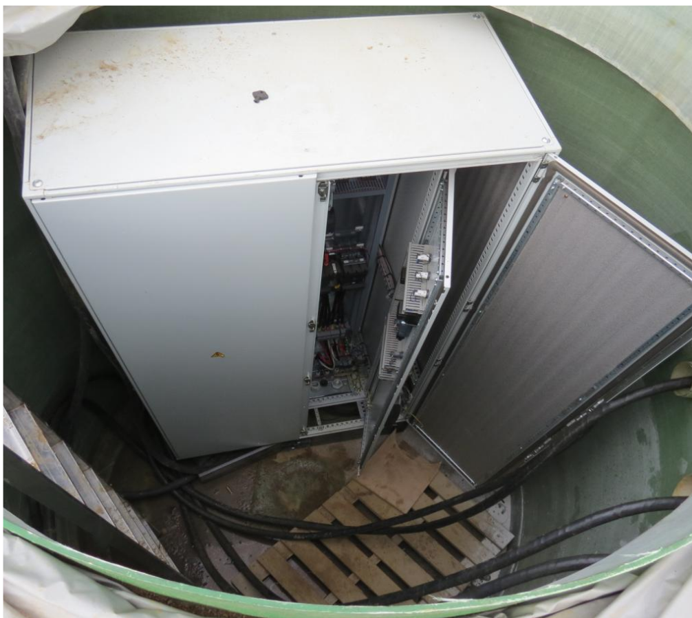
Рисунок 10 - Шкафы управления КНС-5 (ЛСТ)
