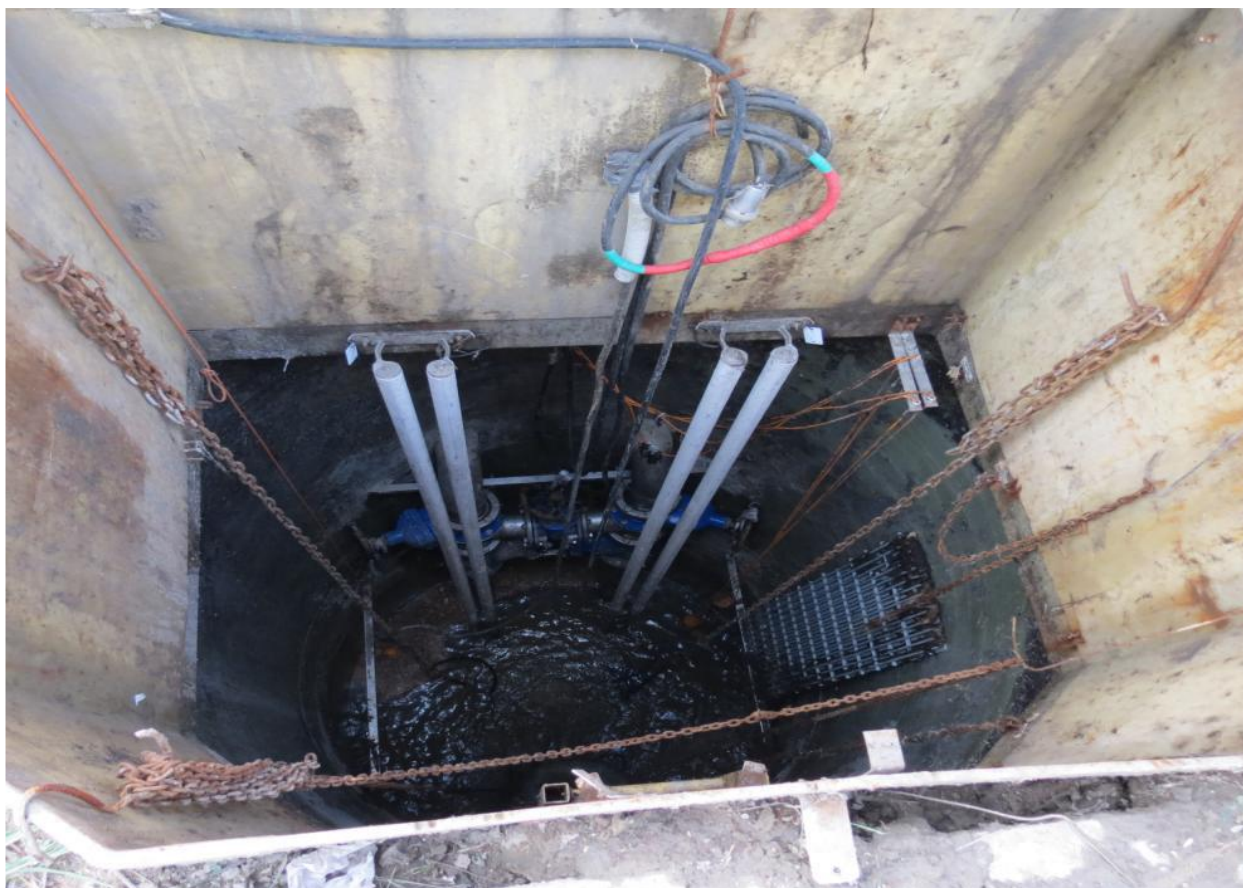
Рисунок 15 - Внутренний вид КНС (ЗАО РТ ПН)
